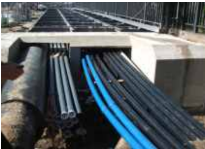
Leitungen Medienträger im Überbau- Westseite
