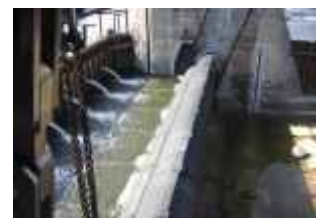
Gefluteter Wehrverschluss zur Funktionsprüfung
