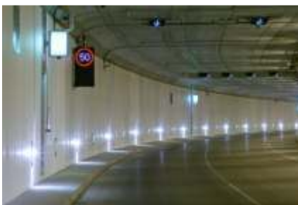
Brandnotleuchten in Funktion
