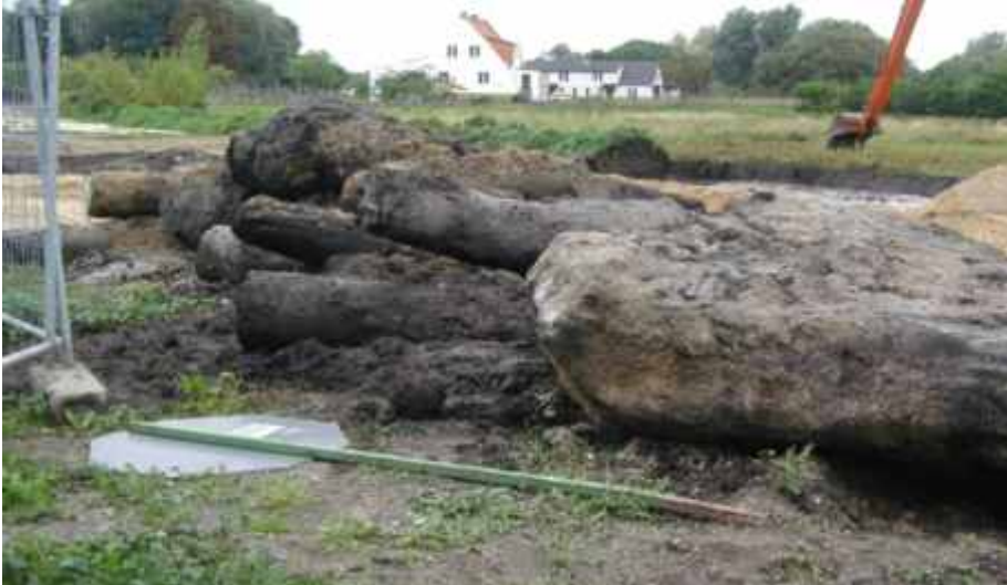
Ausgegrabene Rüttelstopfsäulen (nicht tragfähig)
