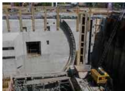
Oberhaupt: Lager des Segmenttores
