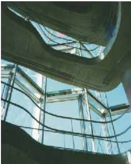
Deckenöffnungen für Ziehturmeinheit
