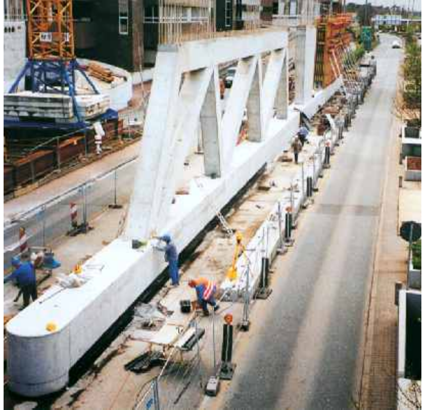
Abfangträger Stützenreihe über Tiefgarage
