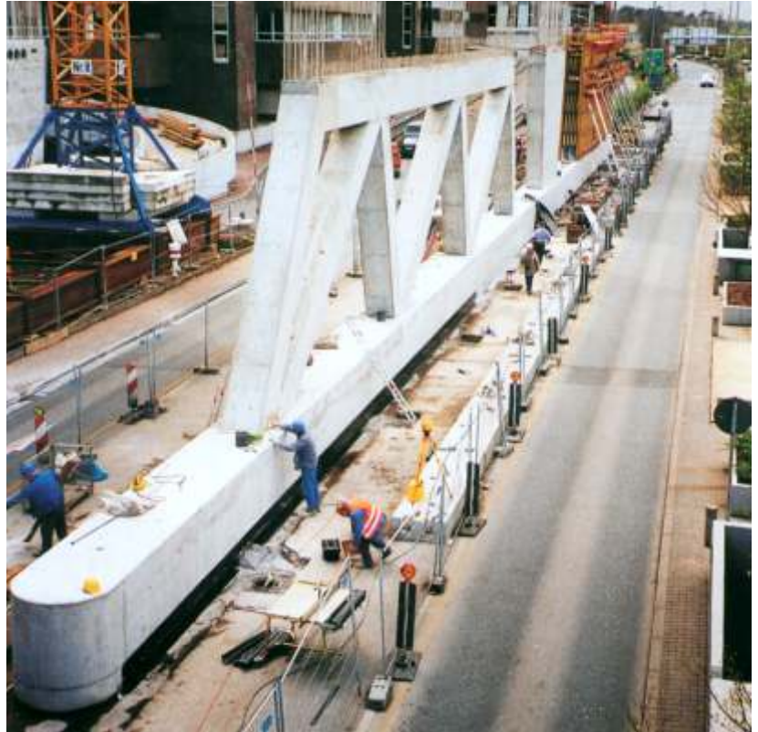
Abfangträger Stützenreihe über Tiefgarage
