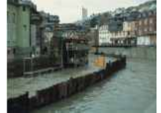
Überflutung der Baustelle bei Hochwasser
